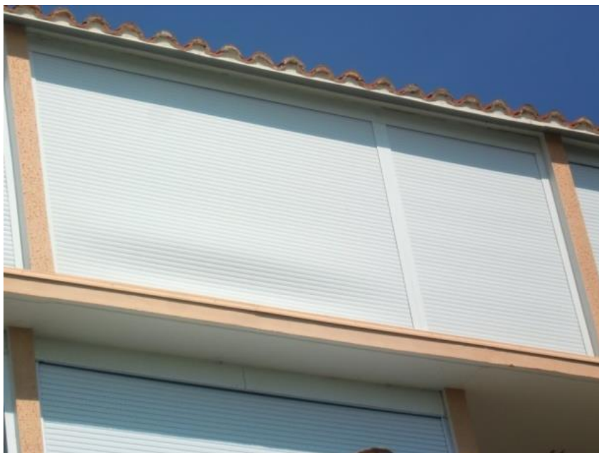
Figure 2 – Bombement du tablier d'un volet roulant
